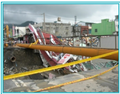
2005年海棠颱風 楓港橋斷橋
