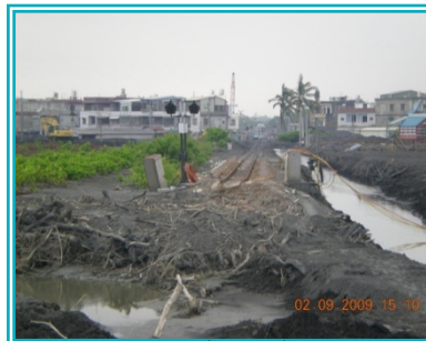
2009年莫拉克颱風 林邊鐵路橋斷橋
