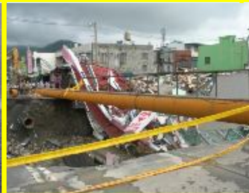
2005年海棠颱風 楓港橋斷橋
