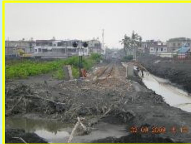
2009年莫拉克颱風 林邊鐵路橋斷橋
