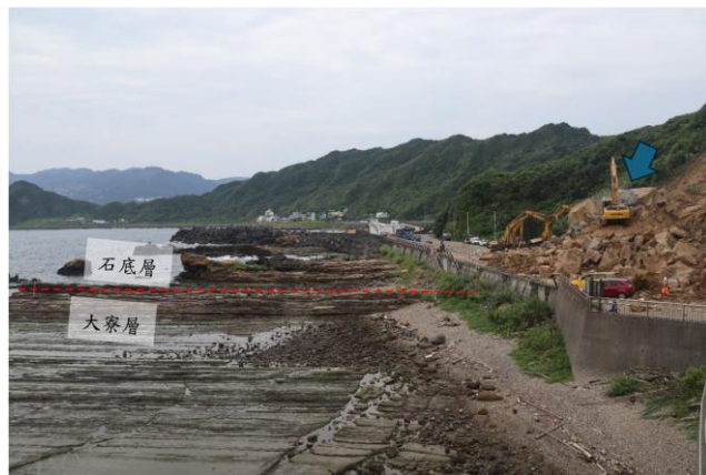
圖 4、現場崩塌地之地層交界圖
