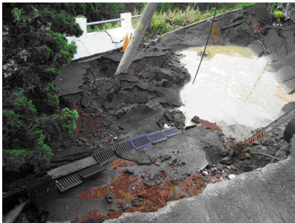
圖 5-6 大雅路二段 386 巷擋土牆塌陷(2009/08/12 莫拉克颱風後照)
