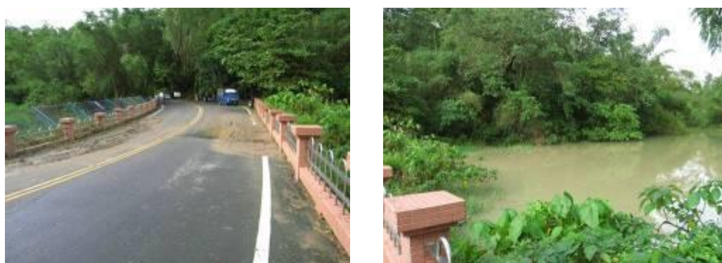
圖 5-8 蘭潭週邊二漢坡登山步道路口前河岸崩塌（箭頭處）
