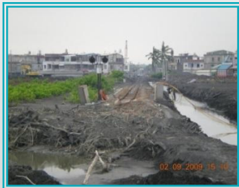
2009年莫拉克颱風 林邊鐵路橋斷橋
