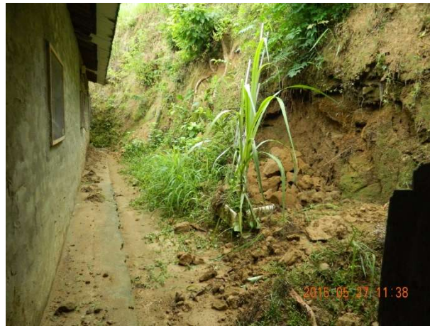
圖 1-34 鹿寮段 647 地號淺層土壤因雨水沖刷而裸露
