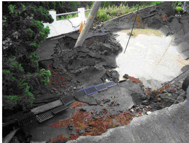
圖 1-33 大雅路二段 386 巷擋土牆塌陷(2009/08/12 莫拉克颱風後照)
