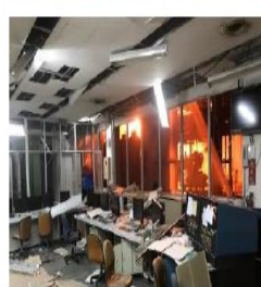
控制室毀損情形
