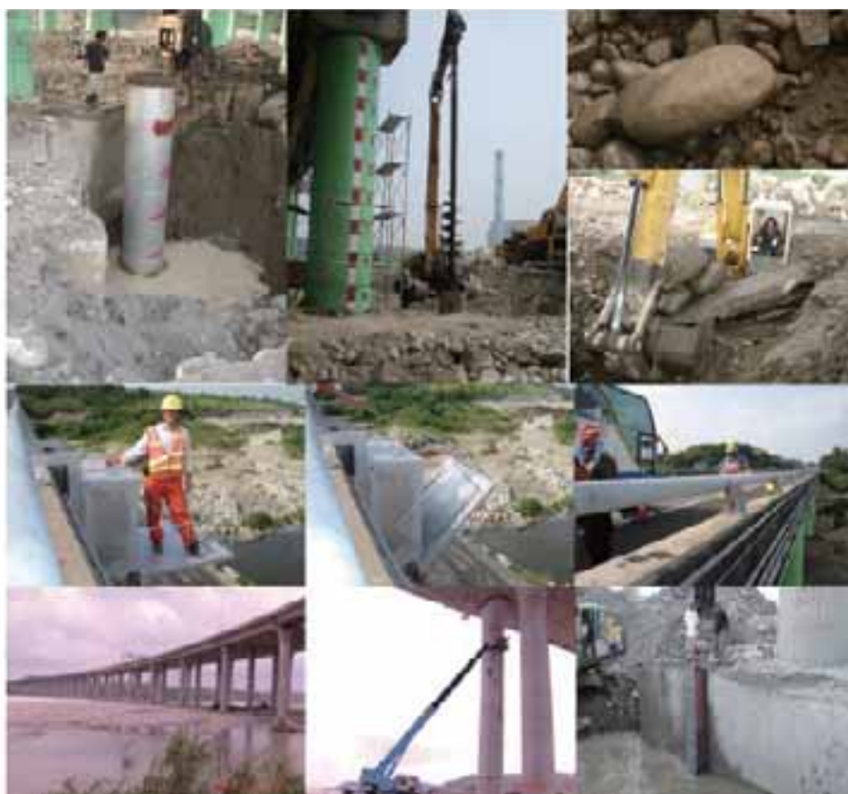
圖2-15：大甲溪國道1號及3號高速公路橋墩基礎監測系統安裝 資料來源：國家地震工程研究中心
