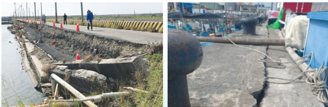
圖4-64 0823熱帶低壓水災災損及地層下陷情形
