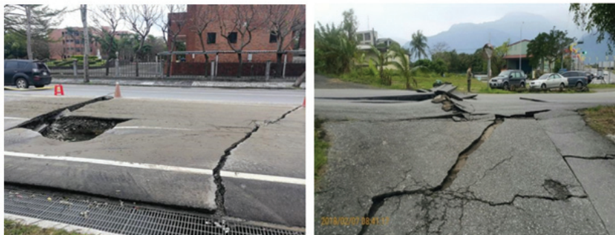
花蓮縣花蓮市華西路震後復建工程及新興路災害搶修工程
