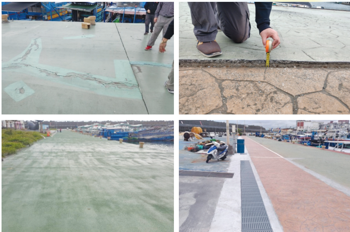
圖4-63 0206花蓮震災後花蓮漁港現勘及復原情形
