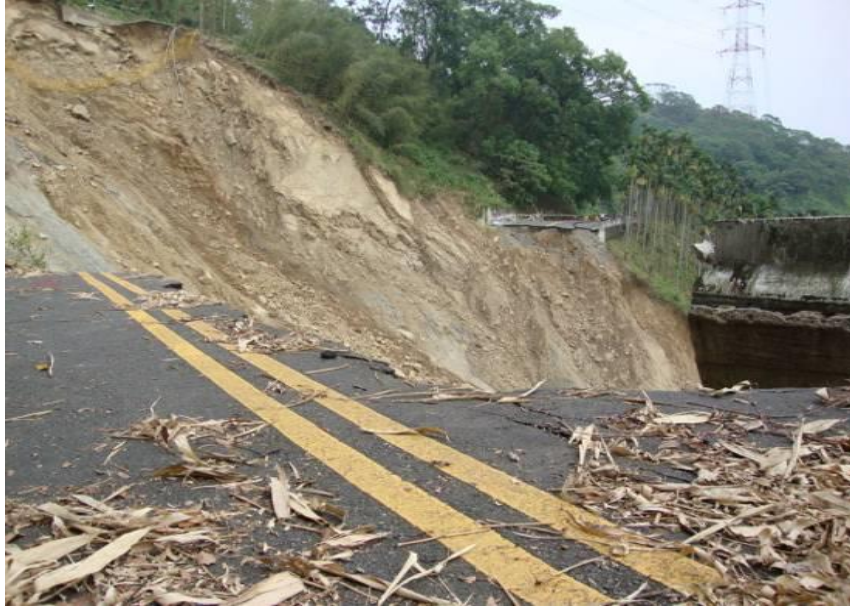
圖 1-10 坡地土石崩塌災情-莫拉克颱風-樟湖村雲 159 甲線
