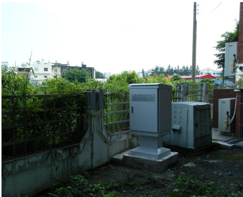
圖 10-16 本縣輻射監測設備設施概況-1
