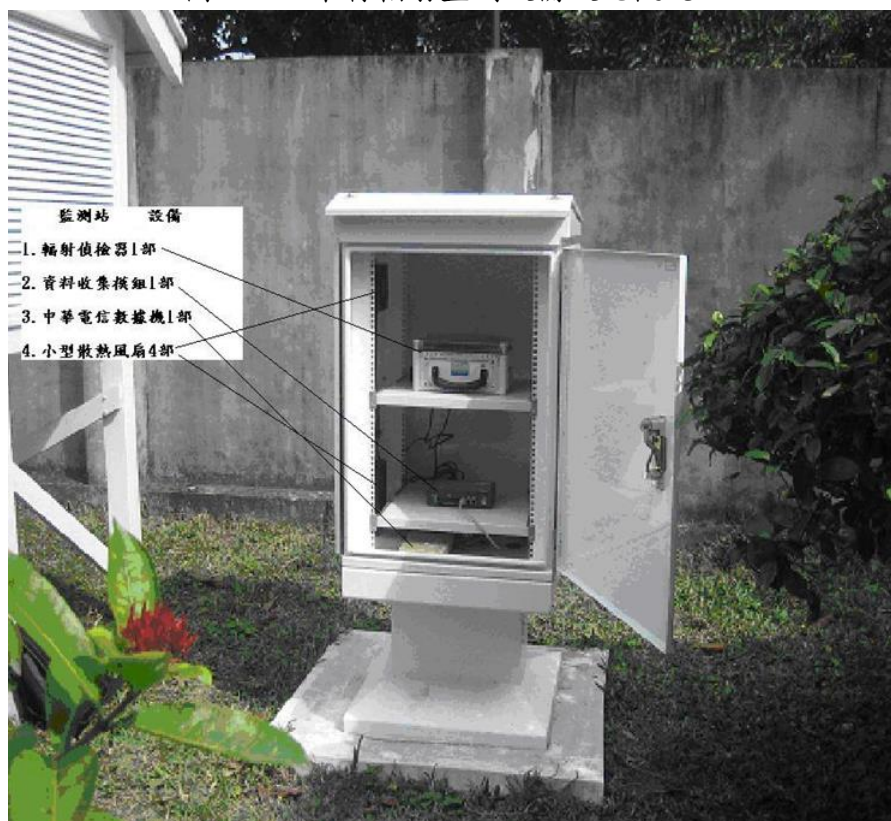
圖 10-17 本縣輻射監測設備設施概況-2
