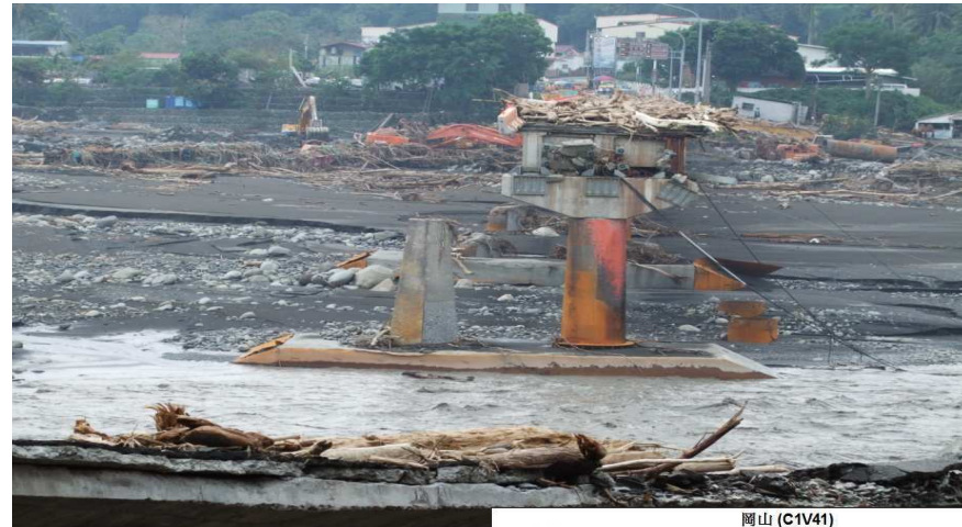
莫拉克颱風造成的橋樑斷裂
