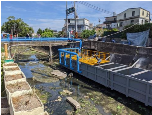
圖 16 中港溪尖山下圳抽水至東興淨水場
