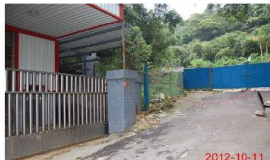
圖 36 土石流潛勢溪流-桃市 DF006 於 101 年 0610 暴雨土石沖刷至廠房
