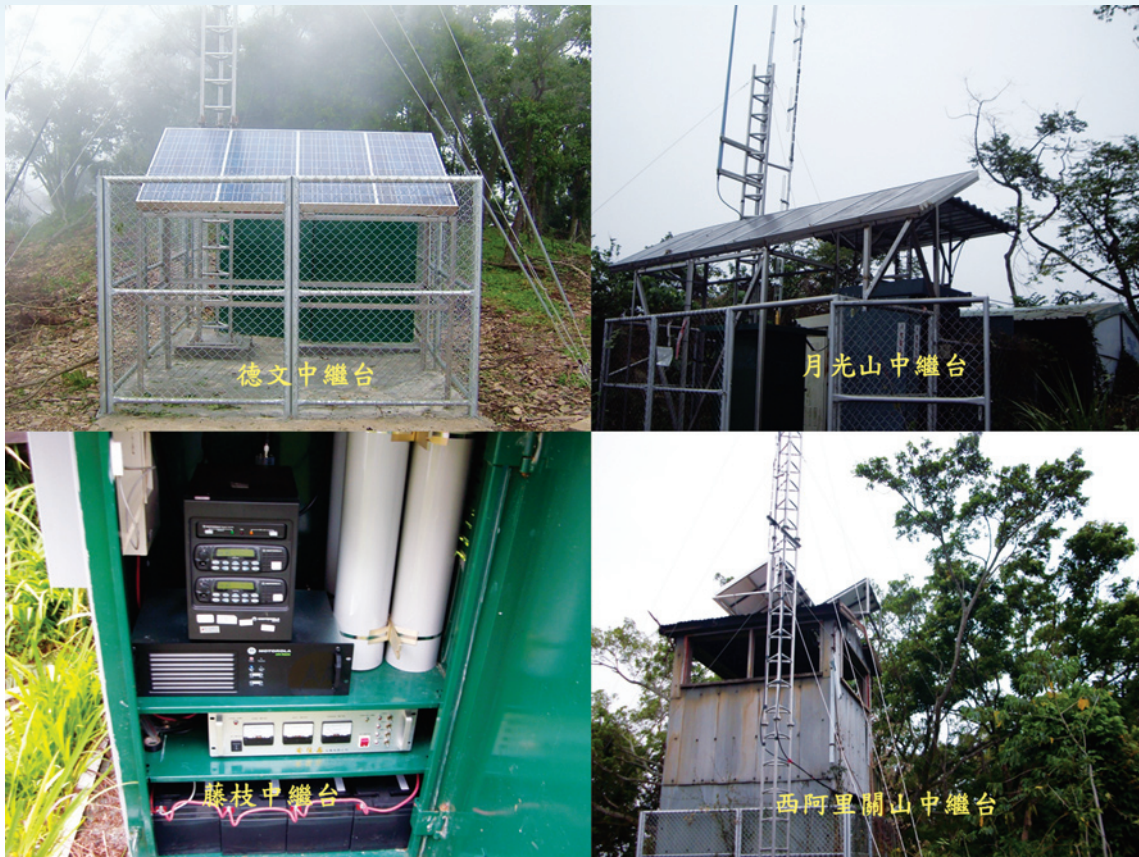
圖3-25 無線電中繼台
