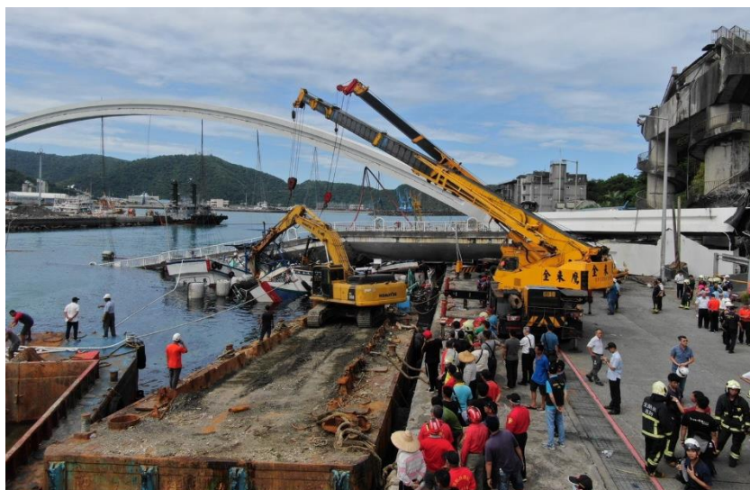
圖 2、南方澳跨港大橋斷橋事件現場救援實況
